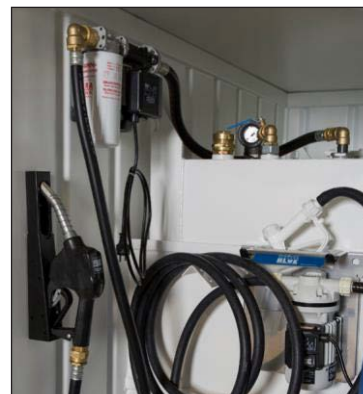
Förråd för Ad-Blue trumma och pumputrustning.
